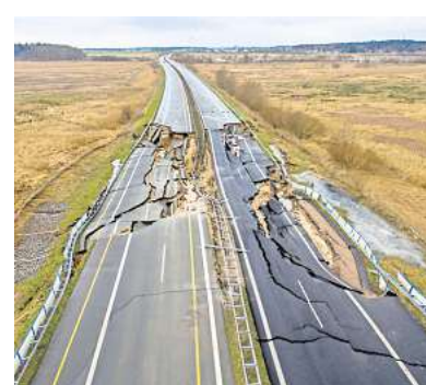
„Nur eine Frage der Zeit“: Am Wochenende brach auf der Autobahn 20 ein weiteres Stück weg. FOTO: MÜLLER
